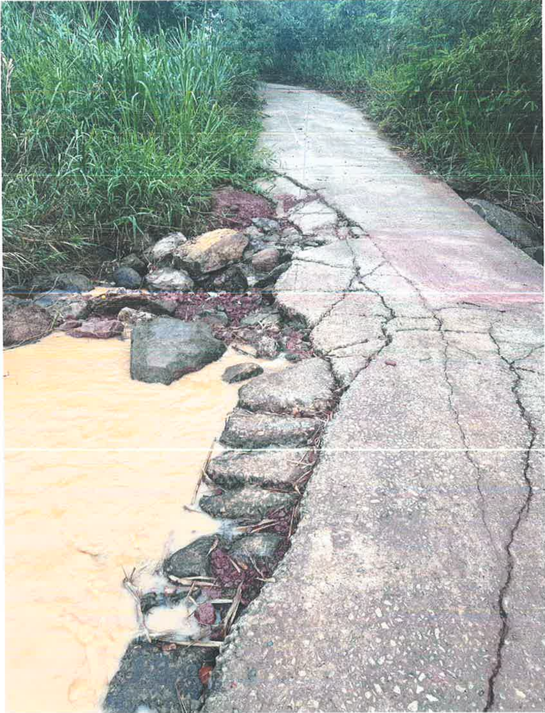
ถนนคอนกรีตเสริมเหล็กบริเวณทางข้ามลำกระจวนบ้านโนนจำปา หมู่ ๑๓ ตำบลนาขาม อําเภอสทิต จังหวัดชัยภูมิ
